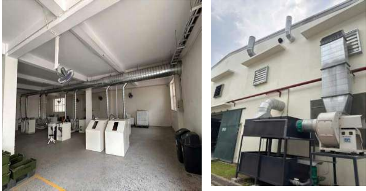
Hình 2.15. Ảnh hiện trạng hệ thống thu gom, XLKT tại dây chuyền phốt 2
