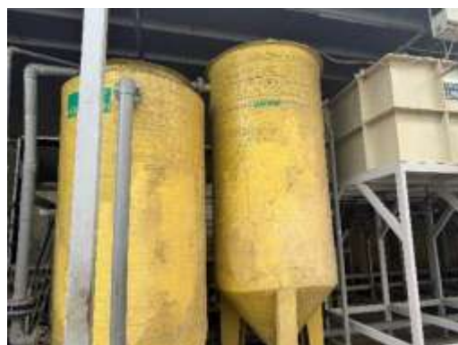
Hệ thống bể phản ứng, bể lọc
