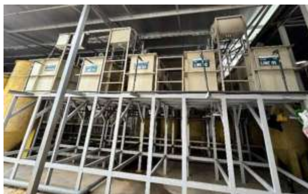
Hệ thống bể phản ứng
