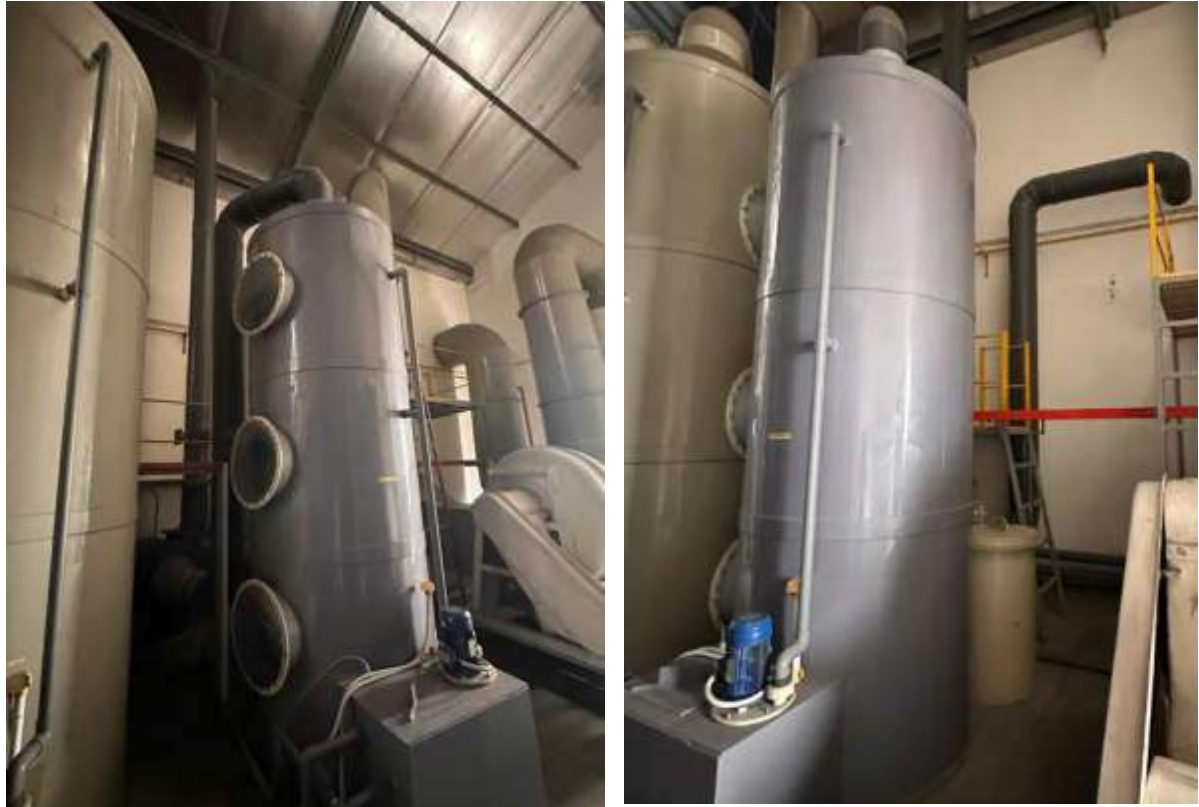
Hình 2.19. Ảnh hiện trạng hệ thống thu gom, XLKT tại dây chuyền mạ Crom
