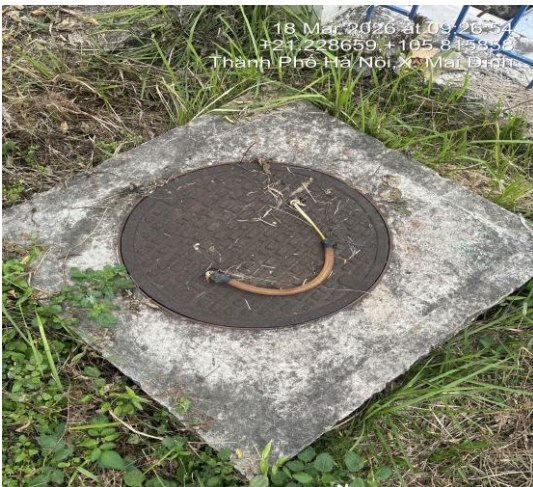
(Điểm đầu nối nước thải sinh hoạt)
