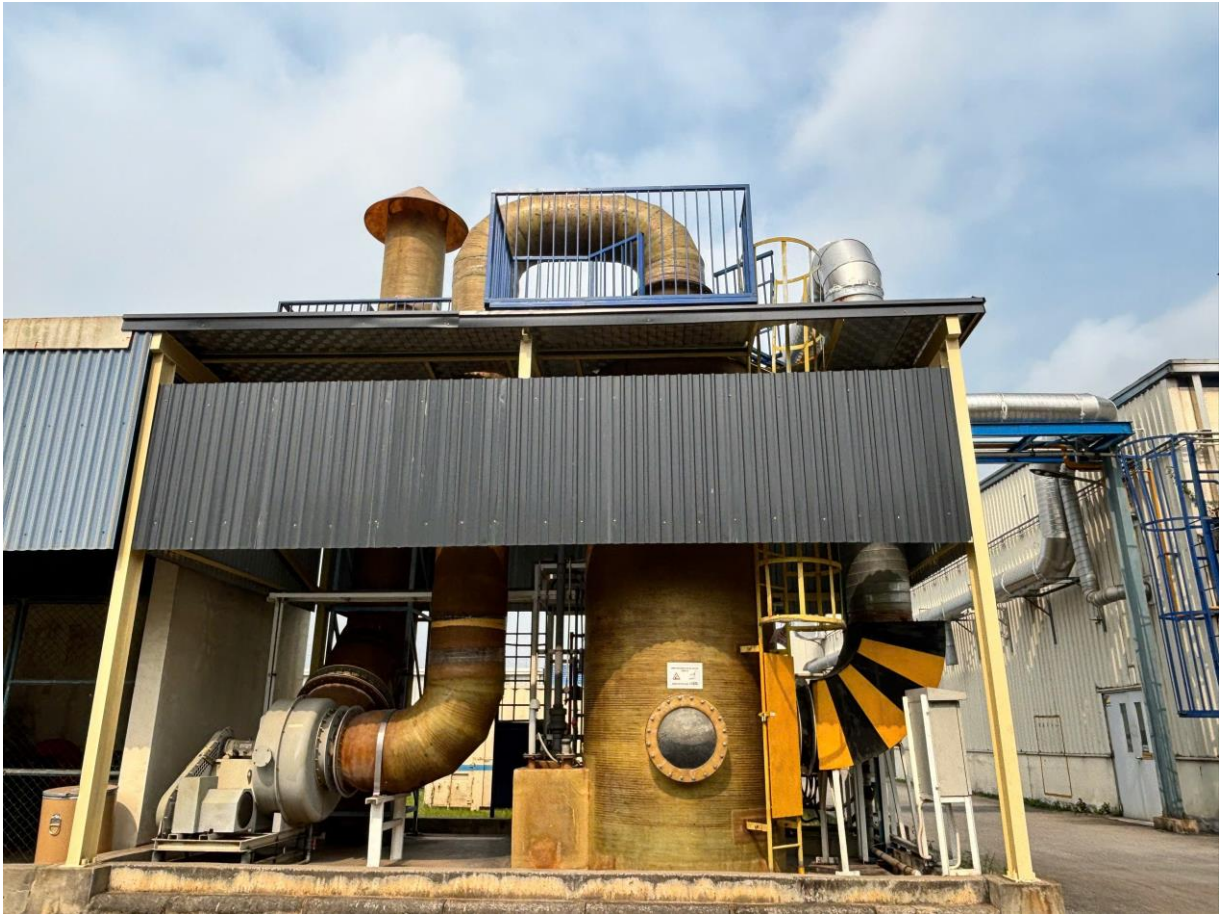
Hình 3.17. Hình ảnh hệ thống xử lý khí thải 18.000 m 3 /giờ Quy trình công nghệ xử lý khí thải như sau:
