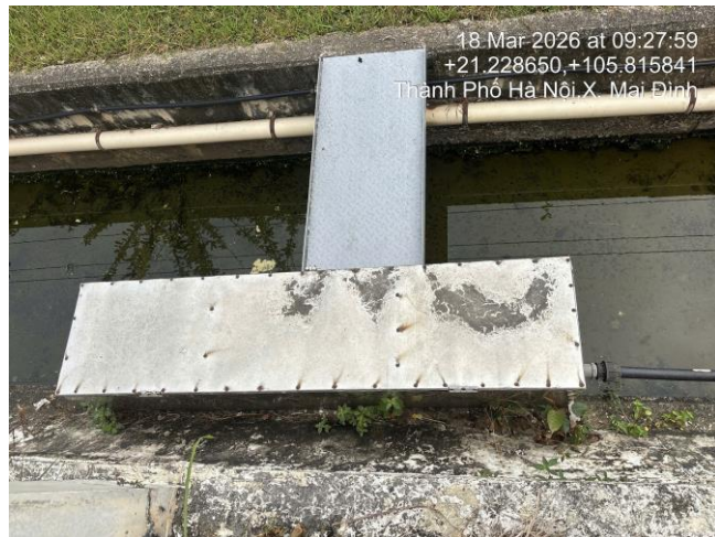
(Điểm đầu nối nước thải công nghiệp)
