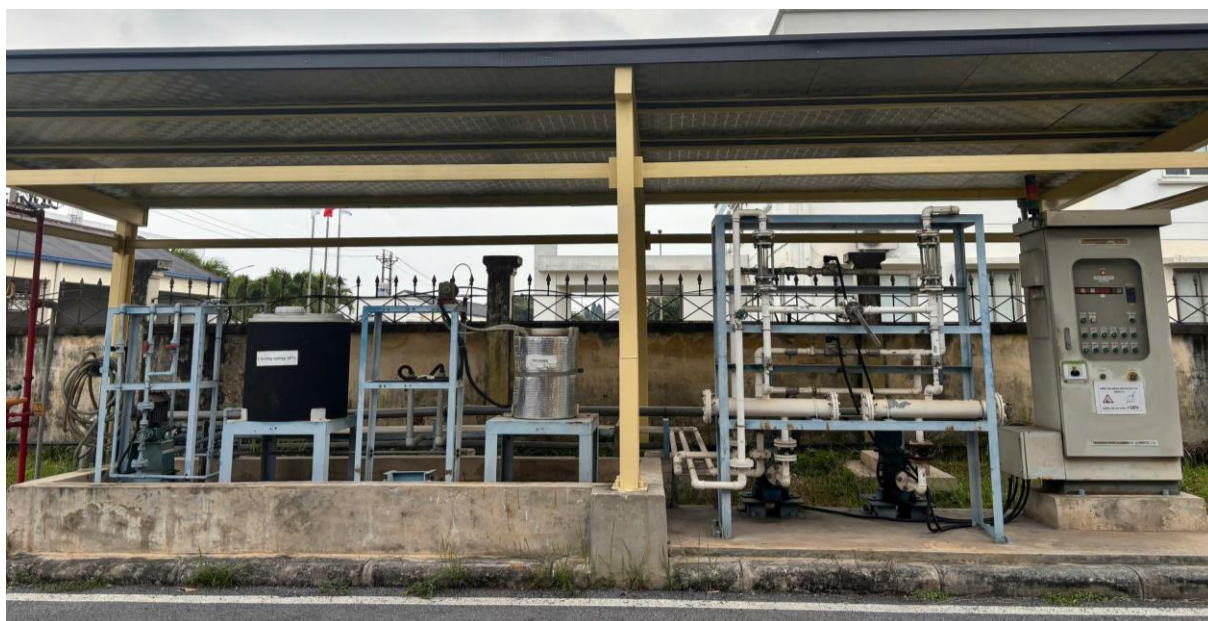
(Khu vực tủ điều khiển và bồn châm hóa chất – được bố trí trong khu vực mái che)
