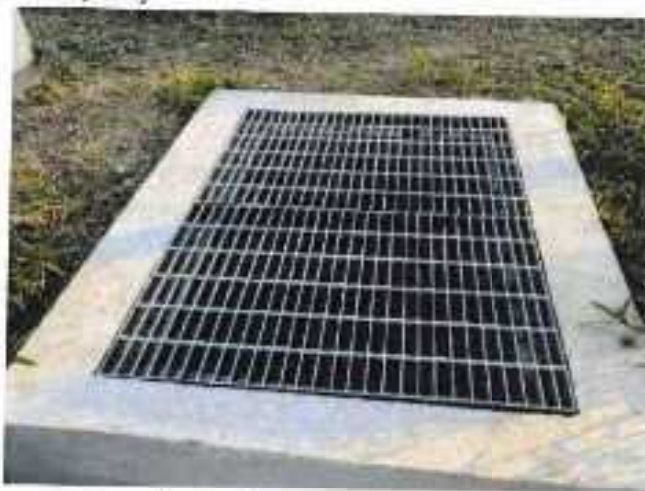
Hình 8 Hồ ga cuối thoát nước thải của cơ sở
