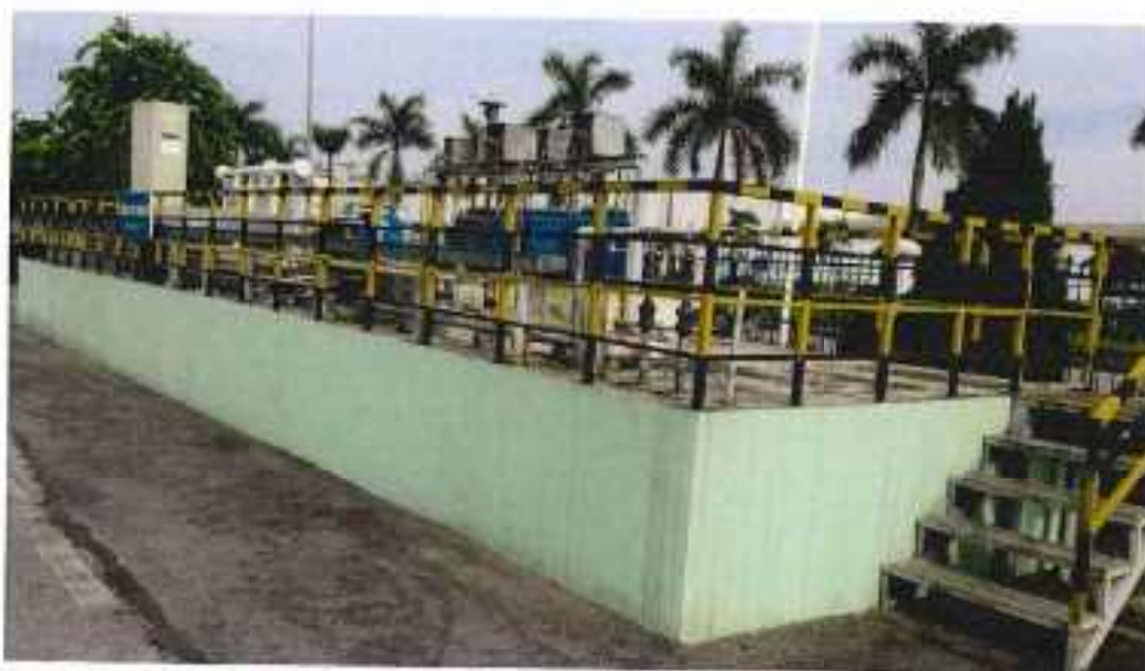
Hình 10 Trạm xử lý nước thải công suất 50 m 3 /ngày đêm
