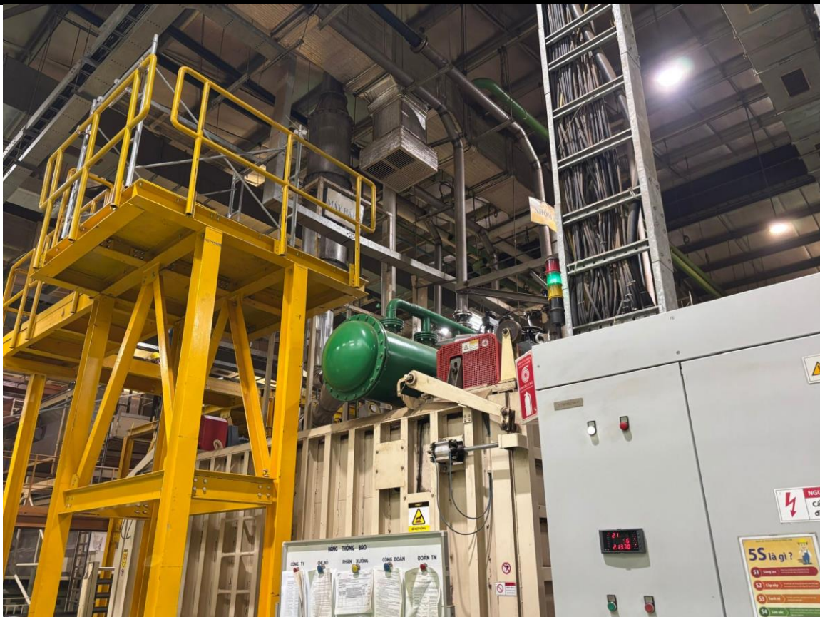
Hình 3.18. Hệ thống thu gom mùi phát sinh từ máy hấp chân không
