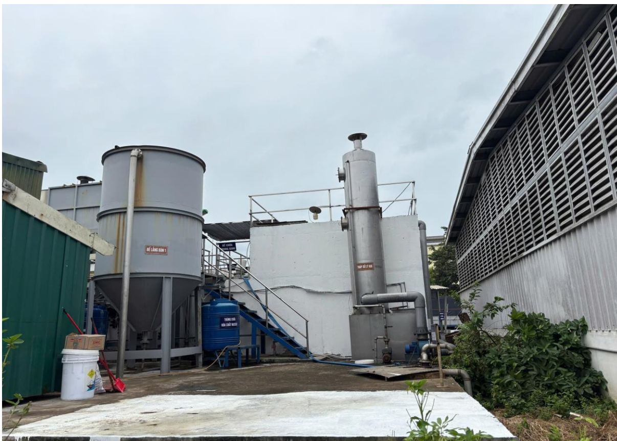
Hình 3.8. Hình ảnh khu vực tháp xử lý mùi của trạm xử lý nước thải tập trung
