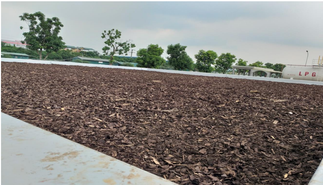
Hình 3.4. Lớp vật liệu lọc tại bể vi sinh (công đoạn xử lý cuối cùng của HTXL mùi)
