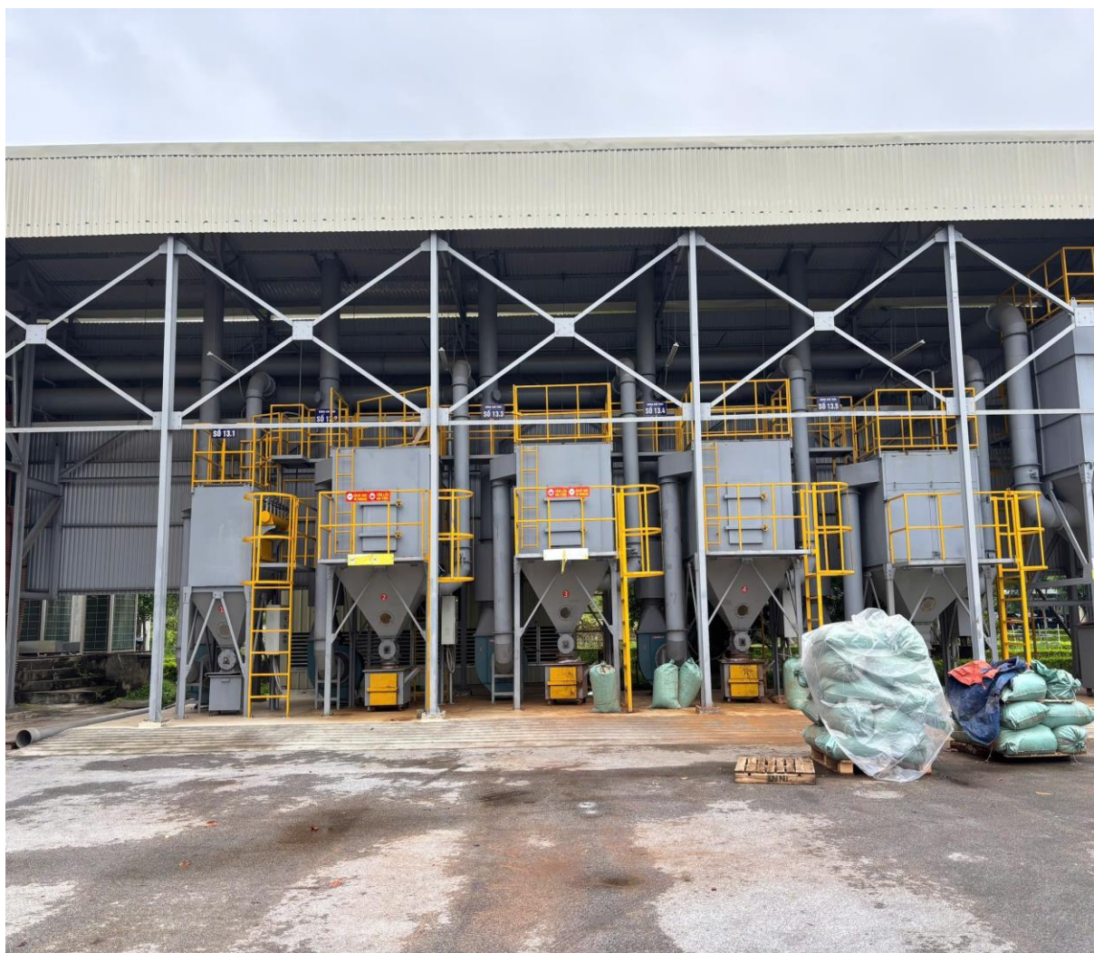
Hình 3.13. Hình ảnh hệ thống xử lý bụi từ dây chuyền cuốn điều – đóng bao của Phân xưởng Hợp tác quốc tế và Phân xưởng Cuốn điều – Đóng bao mở rộng
