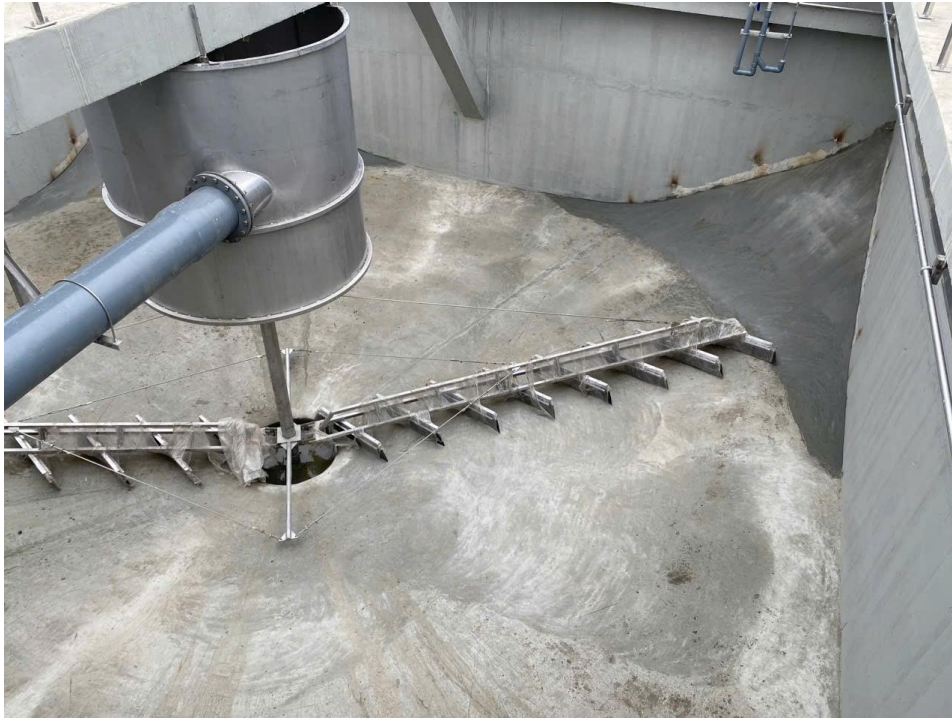
Bể lắng hóa lý
