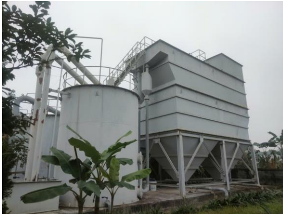
Hệ thống xử lý nước mặt
