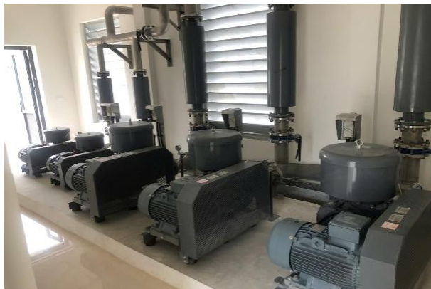
Phòng đặt máy bơm thổi khí của Nhà máy xử lý nước thải
