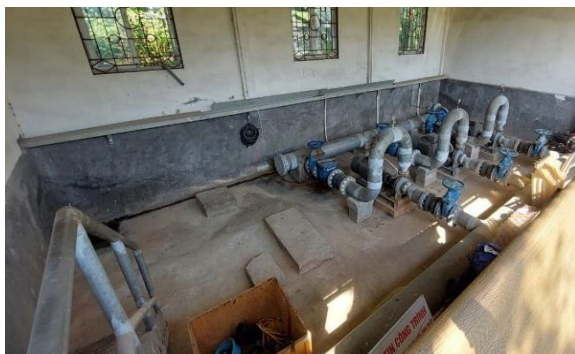
Phòng đặt máy bơm của Nhà máy khai thác, xử lý nước mặt
