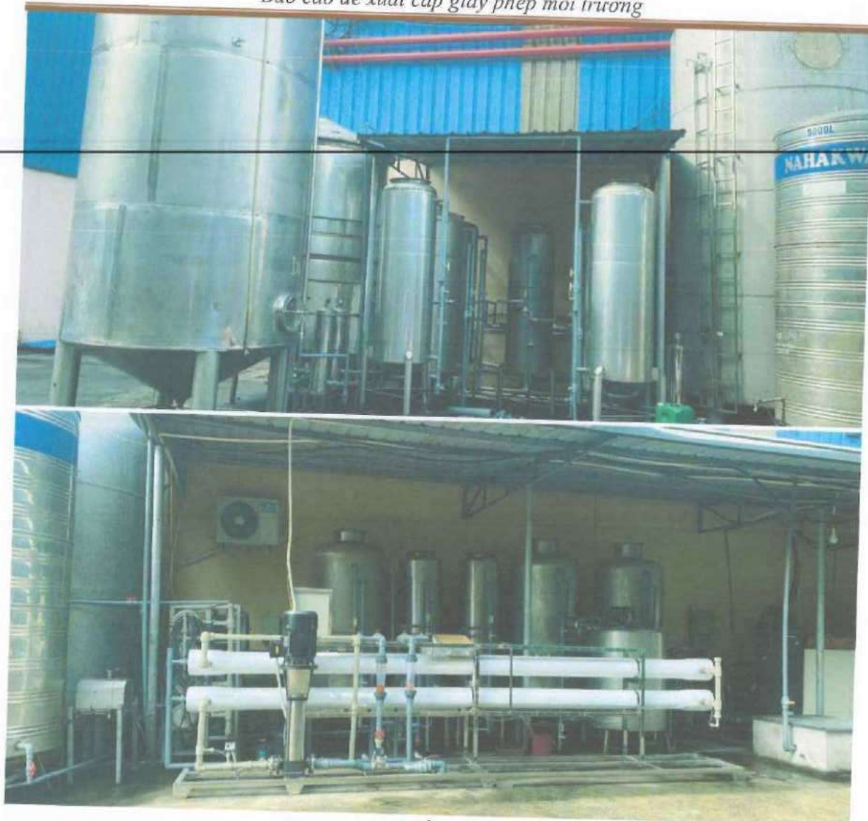
Hình ảnh hệ thống lọc nước RO
