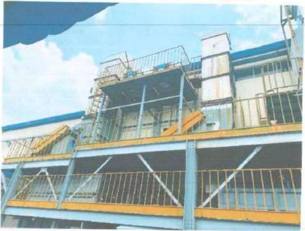
Hình 29 Hình ảnh hệ thống đập bụi ướt
