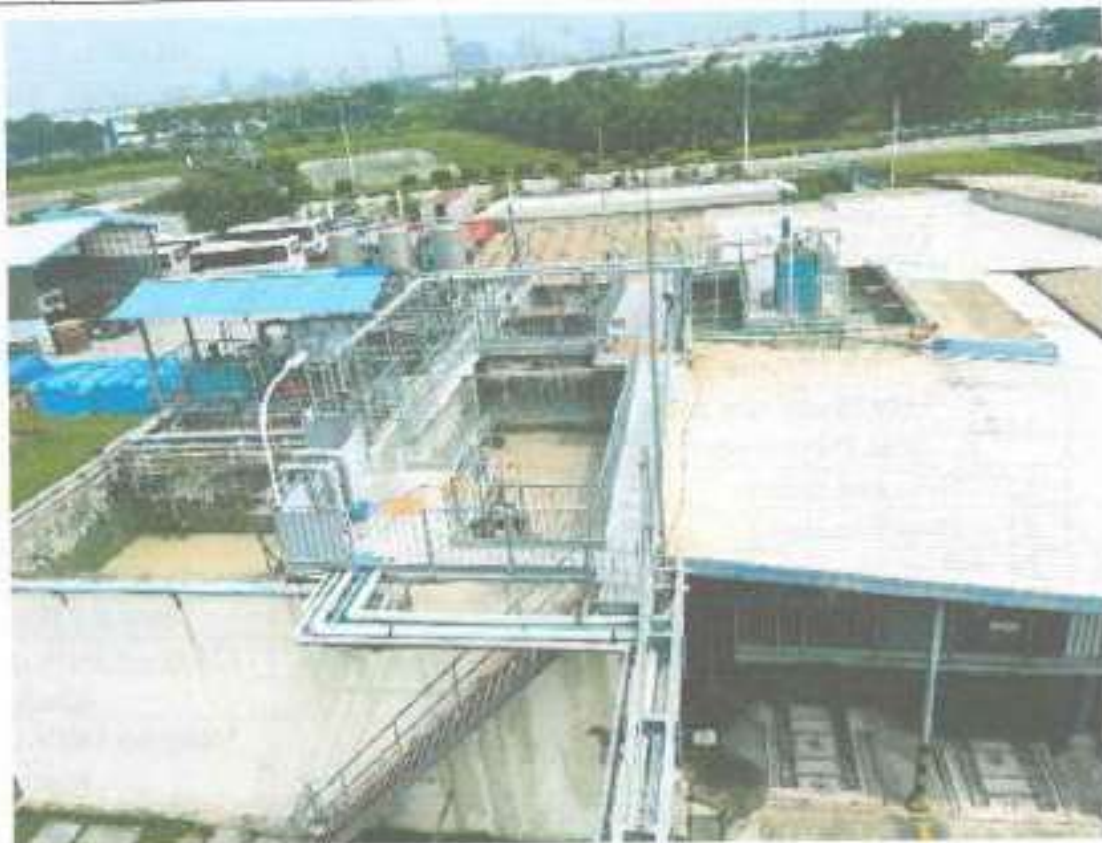
Hình 17 Hệ thống xử lý nước thải sản xuất công suất 800 m 3 /ngày đêm
