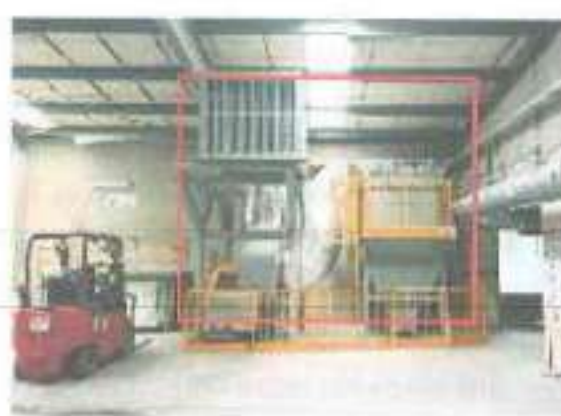
Hệ thống silo tầng 2
