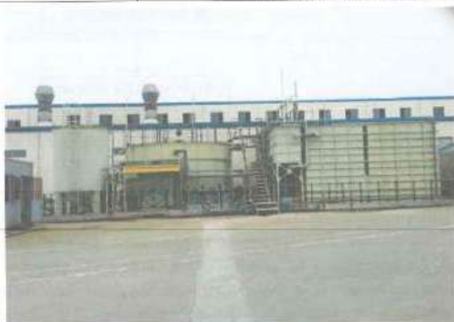
Hình 12 Hệ thống xử lý nước thải sinh hoạt công suất 300 m 3 /ngày đêm
