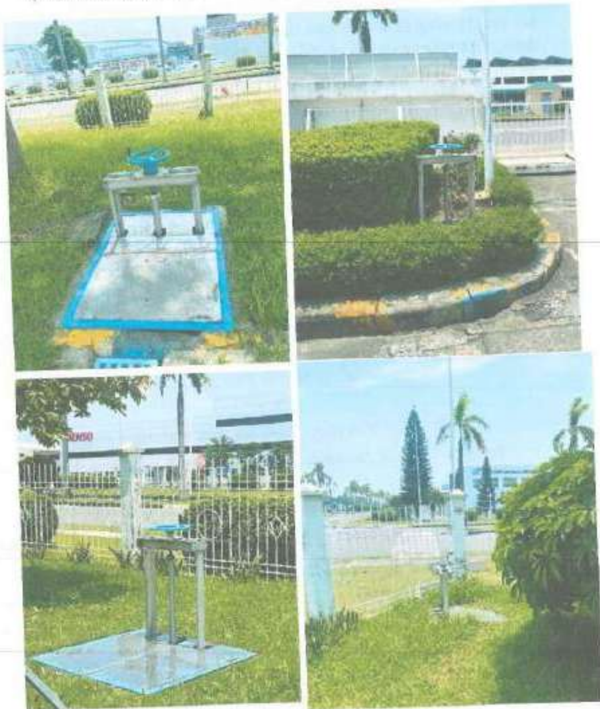
Hình 7 Hình ảnh hồ ga thoát nước mưa của cơ sở
