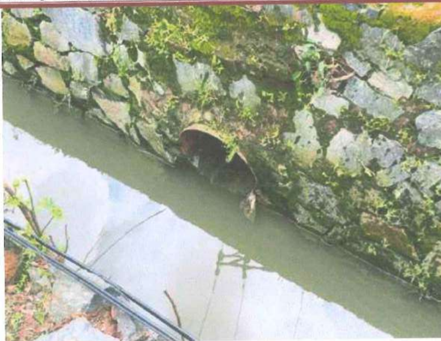
Hình 13. Hình ảnh điểm xả thoát nước mưa của cơ sở
