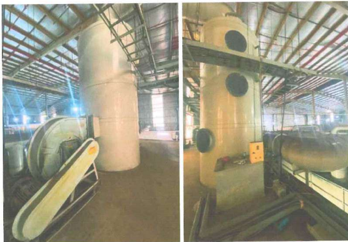
Hình 24. Hệ thống thu gom tháp xử lý số 3
