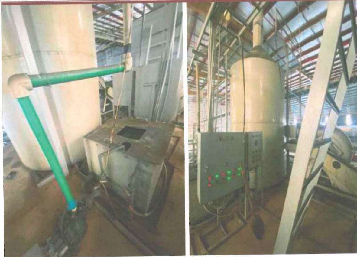
Hình 21. Hệ thống xử lý khí thải số 1
